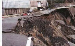
山古志村方面の道路の前壊現場
